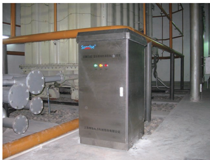
回龙抽水蓄能电站变压器在线监测
