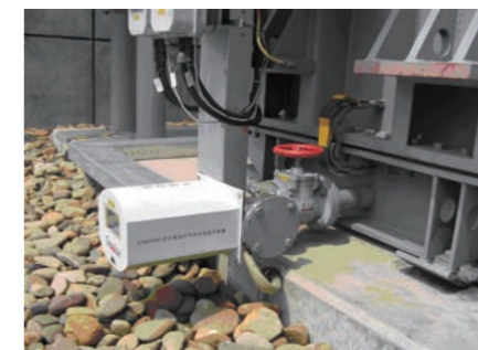
广东梅州500kV变电站变压器在线监测系统
